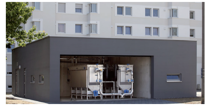
Technikgebäude mit Bypass-Abwasser-Wärmetauscher für eine Wohnsiedlung in Straubing (Abb. von Huber SE, Berching aus: LfU „Energie aus Abwasser – ein Leitfaden für Kommunen“, Christ et. al., 2013)
